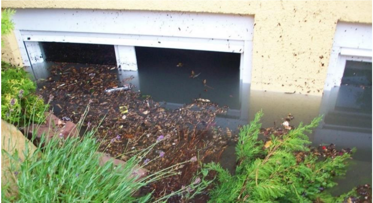
Abb. 62: Überflutetes Untergeschoss bei Starkregen, 2009, Foto: Becker
