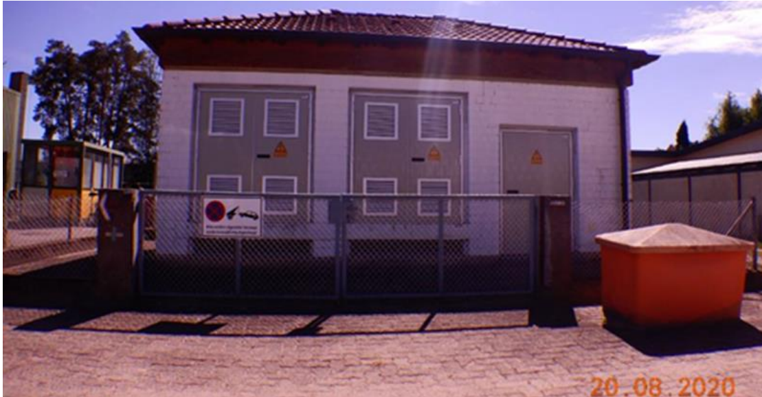
Abb. 74: Beispiel für überflutungsgefährdete Trafostation
