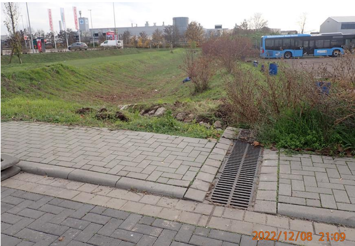
Abb. 26: Beispiel für eine oberirdische Ableitung von Straßenwasser in ein Versickerungsbecken in Haßloch
