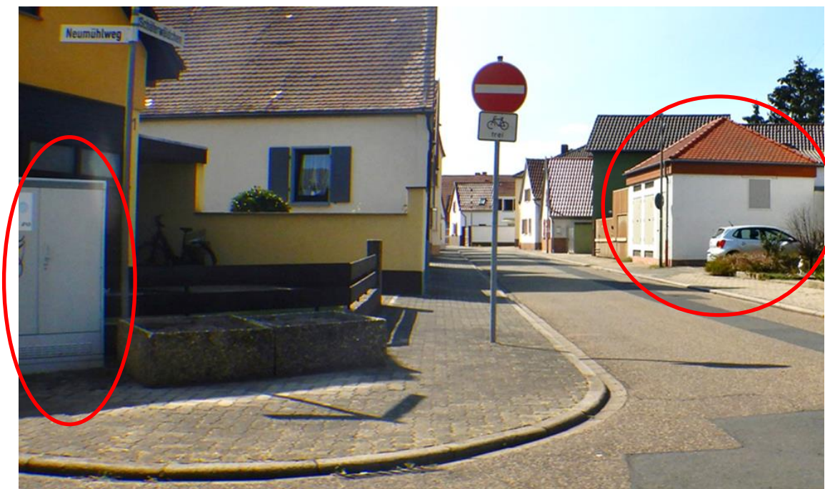
Abb. 75: Beispiele für potenziell überflutungsgefährdete Stromversorgungseinrichtungen
