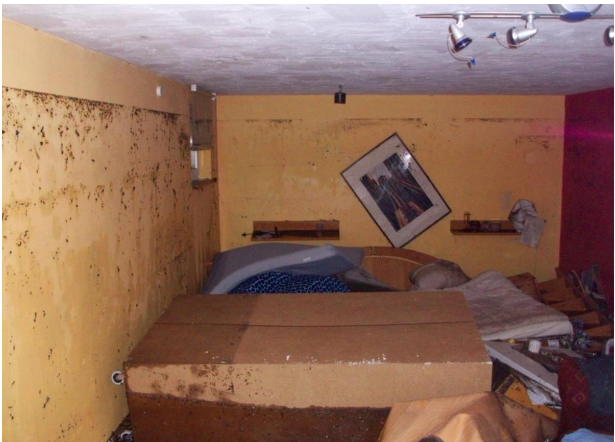
Abb. 65: Zerstörtes Zimmer im Untergeschoss nach Starkregen, 2009, Foto: Becker
