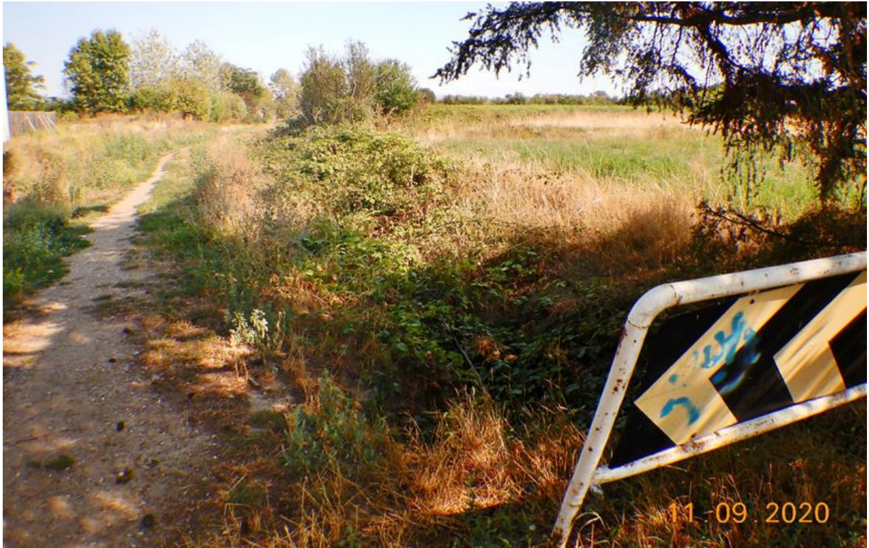
Abb. 40: Zwerggraben mit Unterhaltungsbedarf
